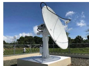
3.5mパラボラアンテナ追尾装置
